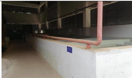
含铁废水处理系统
